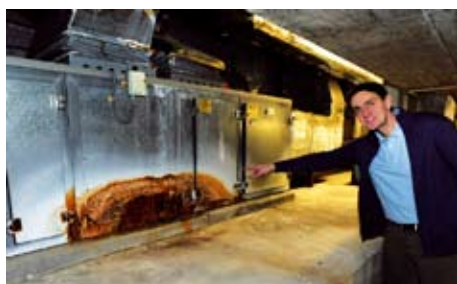
Tagesstättenleiter Rainer Zimmermann führt in die dringend sanierungsbedürftigen Katakomben des Therapiebades
